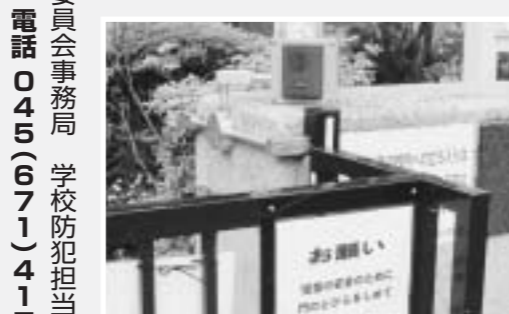
校門に設置されたカメラ付インターホン
